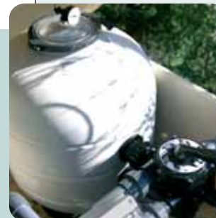
Depuradora Arena Silex
