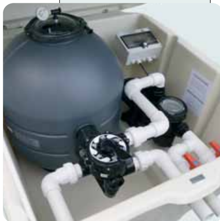
Local Técnico Filtración
